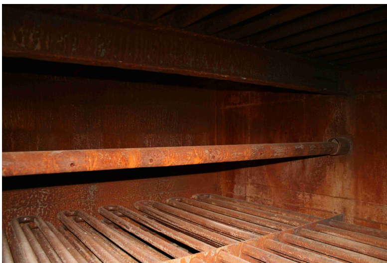
Figur 7. Fast monterad sotblåsningslans mellan två tubpaket i ekonomisern. Nyligen utbytta översta tubrader i underliggande tubpaket.
