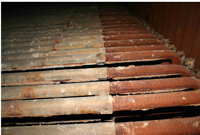
Figur 5. Tuber på ovansidan av primäröverhettaren, tuberna manuellt rensade och nyligen monterade tubskydd.
