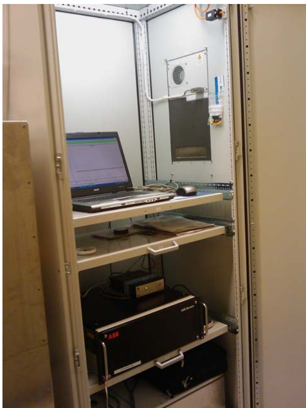
Figur J3. Luftkylt kabinettet med dator och de olika instrumentkomponenterna.
