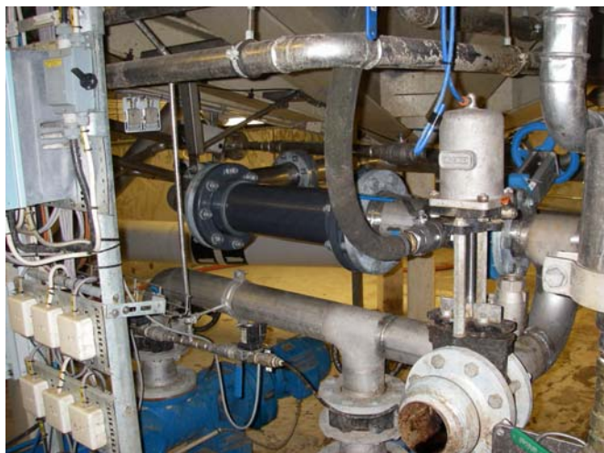
Figur G6. Bild på on-lineslinga för installation av hf-sensors TS-mätare
