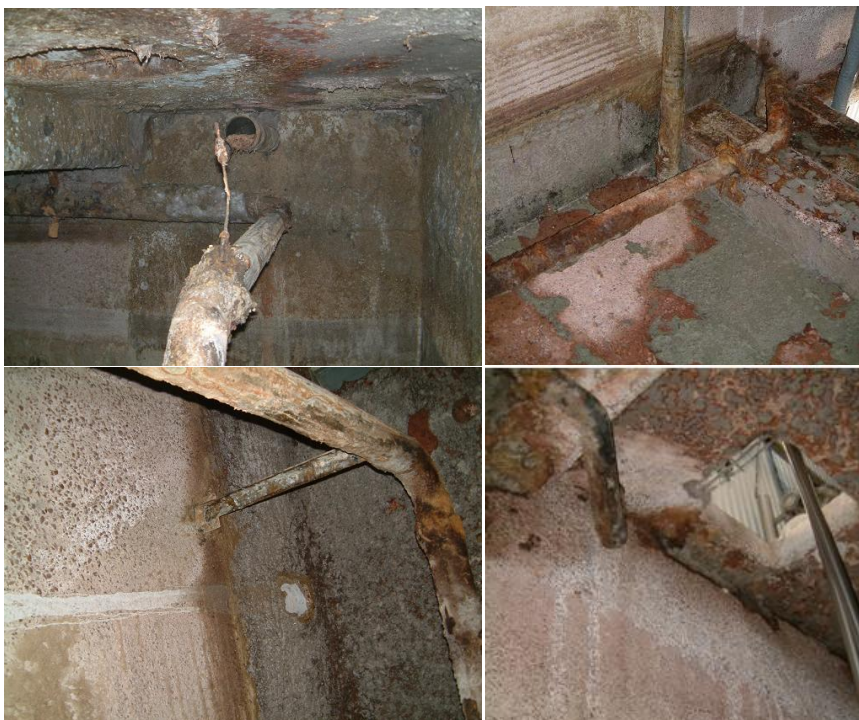
Figur 25. Frätskador på mottagningstank på en biogasanläggning
