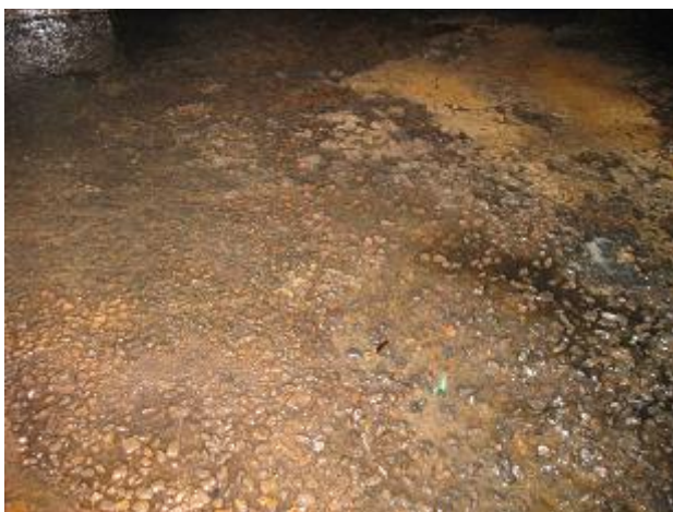
Figur 23. Rost på betonggolv i förbehandlingen
