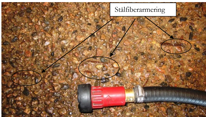
Figur 21. Närbild av betongplattan (golv), området är markerad i figur 20 som ellips nr. 1 (NSR)
