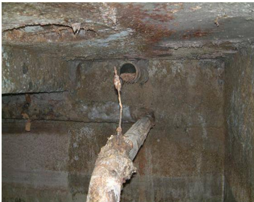
Figur 1. Frätskada på tank i biogasanläggning [Boubitsas 2010]
