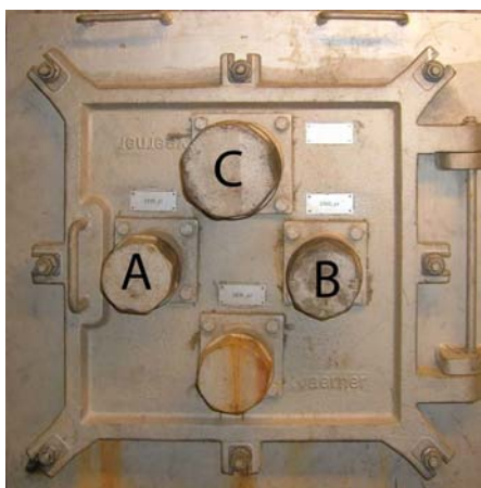
Figur 12. Mätportar i manlucka under överhettarna.
